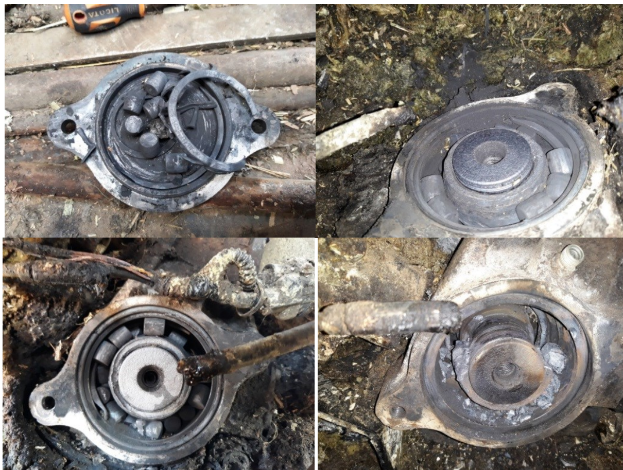
Рисунок 6 – Повреждения подшипников опоры доизмельчителя комбайна RSM 2650
